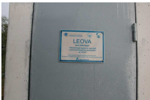
Dveře "budky" pro řídicí jednotku nesou označení projektu rozvojové spolupráce
