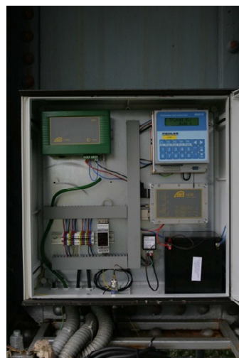
Řídicí jednotka, satelitní vysílač a baterie, stanice Cantemir
