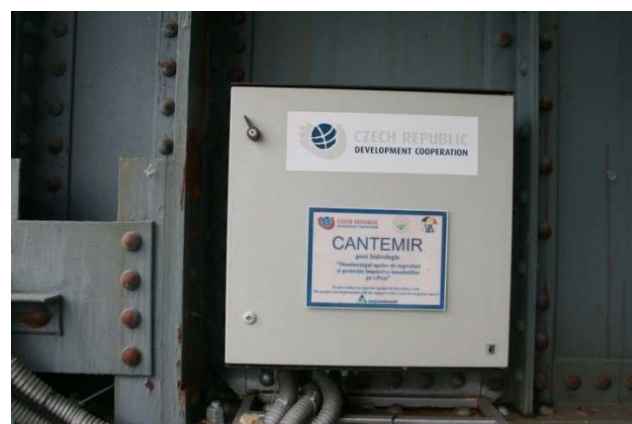
Řídicí jednotka stanice Cantemir
