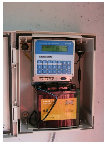
Automatická řídicí jednotka stanice Telenesti
