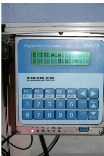
Řídící jednotka ve stanici Sevrova, kde po silných přívalových deštích udává čidlo hodnotu 9,66 m, hodnota je v průběhu času konstantní
