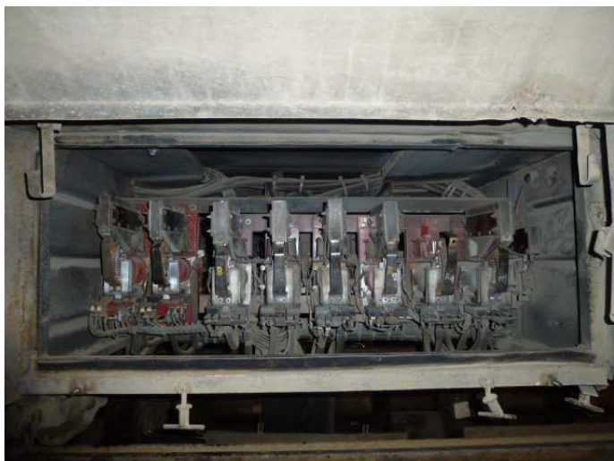
Obrázek 12 Vůz KT8D5 prochází renovací – část elektro
