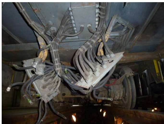
Obrázek 11 Vůz KT8D5 prochází renovací – část elektro
